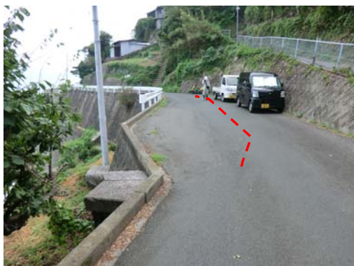
写真-1 C-5 ブロック冠頭部 路面の亀裂・沈下が認められる
