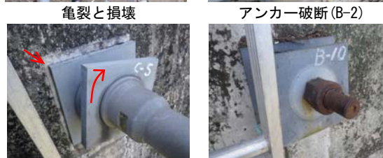
写真-2 頭部キャップの変状状況
