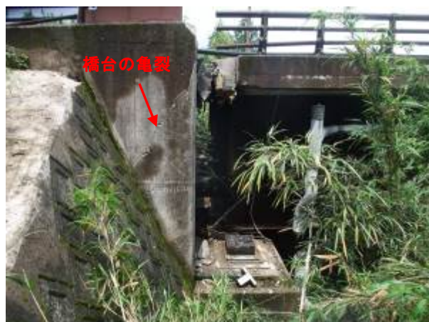
写真-5 大切畑大橋（支承部の損傷）
