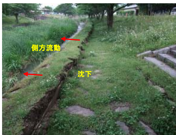
写真-8 秋津川護岸の側方流動と背後の沈下
