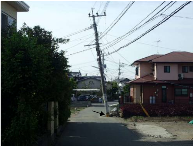
写真-1 液状化による電柱の傾動と沈下
