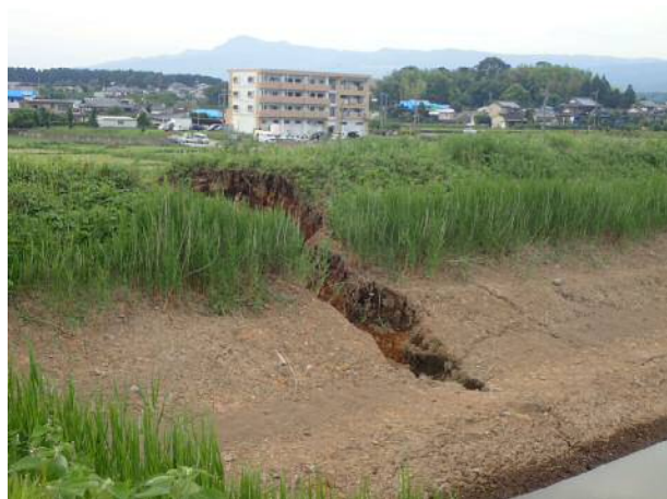
写真-6 下小森ため池の破堤状況
