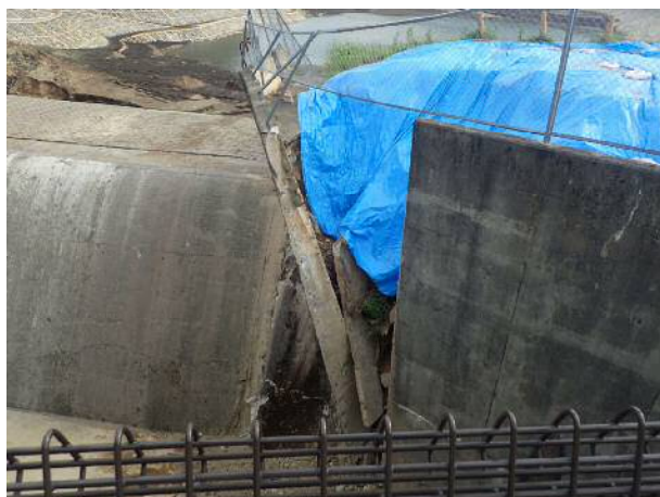
写真-4 大切畑ダムの損傷した洪水吐
