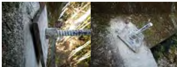
写真-4 プレートの浮き上がり 写真-5 プレートの回転
