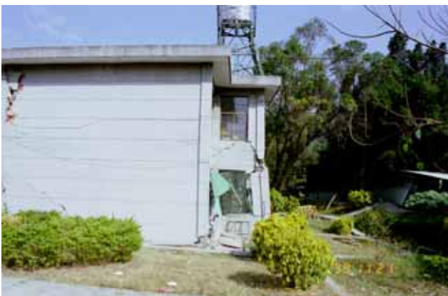
写真 - 11 建物の被害(その1)
