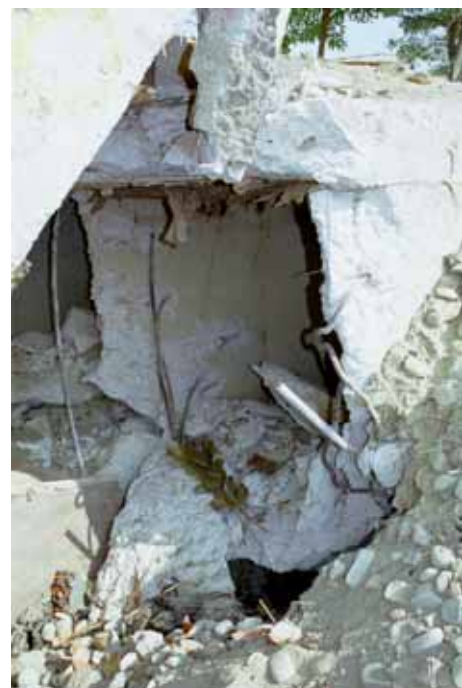
写真 - 4 ボックスカルバートの破断(その2)
