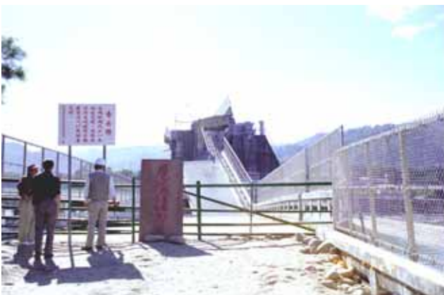
写真 - 3 ダム本体の被害状況 (その2)
