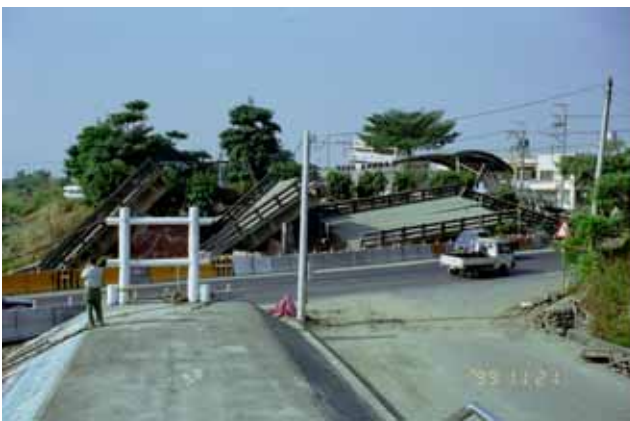
写真 - 2 橋桁の落下(その1)
