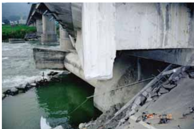
写真 - 4 倒壊した橋脚
