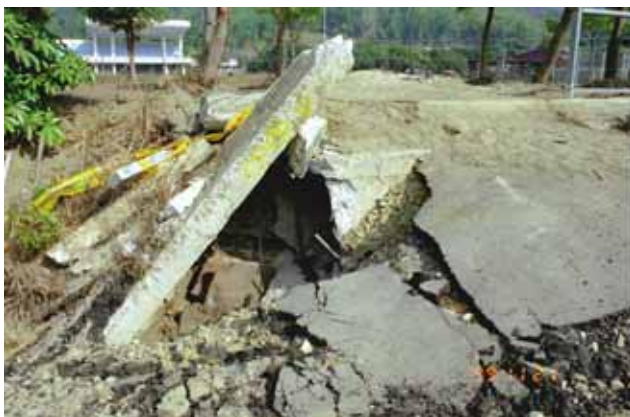
写真 - 3 ボックスカルバートの破壊(その1)
