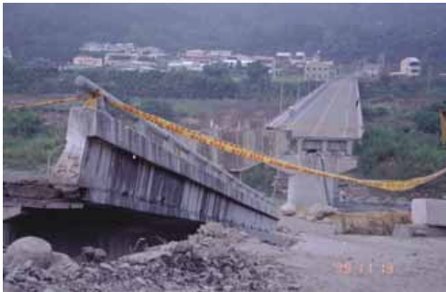
写真 - 1 被害全景(その1)
