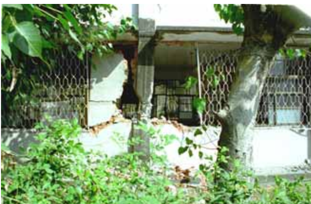
写真 - 12 建物の被害(その2)
