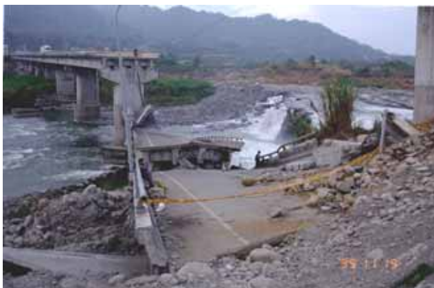
写真 - 3 被害全景(その3)
