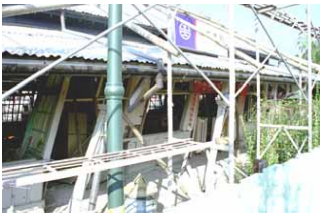
写真 - 2 集集駅の被害(その2)
