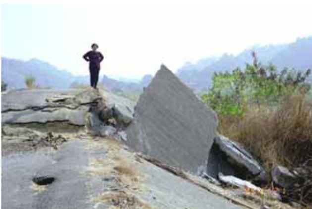
写真 - 2 堤防の被害
