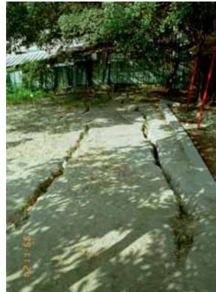
写真 - 10 地面にできた 亀裂
