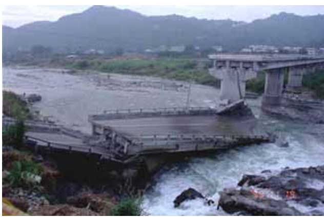
写真 - 2 被害全景(その2)
