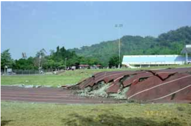
写真 - 5 地表地震断層(その1)
