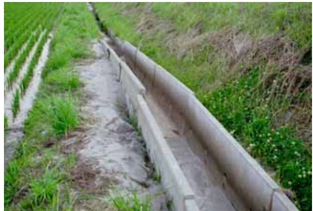
Pho-10 水田わきを流れる水路の被害。 U字溝が浮き上がっている。
