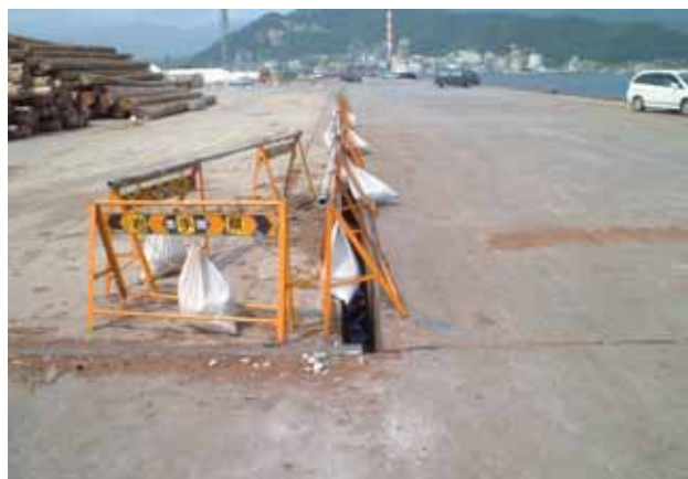
Pho-7 野々田埠頭の被害 . 7.5m 岸壁背後地盤においては 10cm 以上の段差が生じている .
