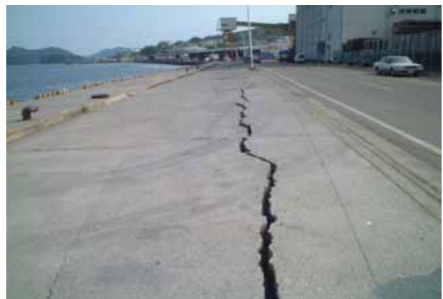
Pho-6 岸壁背後地盤の沈下・亀裂の増大 .
