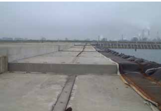
Pho-11 石巻港の新規埋立て地での被害。 ケーソンの不同沈下が見られる。
