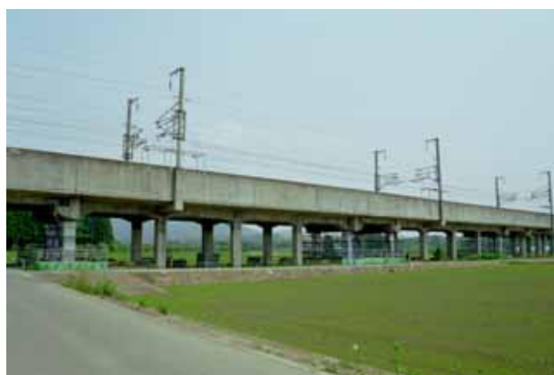
Pho-1 高架橋の被害状況．(4 径間連続ラーメン)高架橋の端部に被害が集中している．
