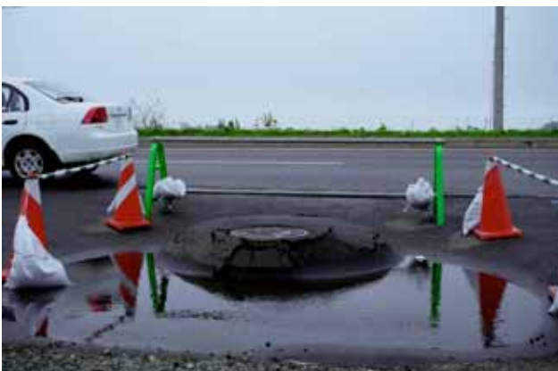
写真 - 21 マンホールの浮き上がりと路面の陥没
