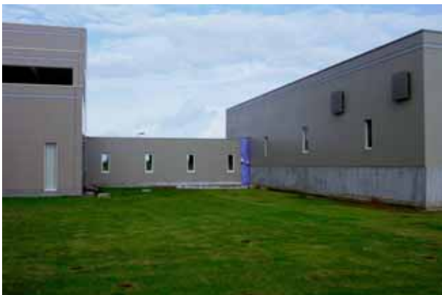
写真 - 9 水処理棟と管理用通路との間の E.P.J にズレ
