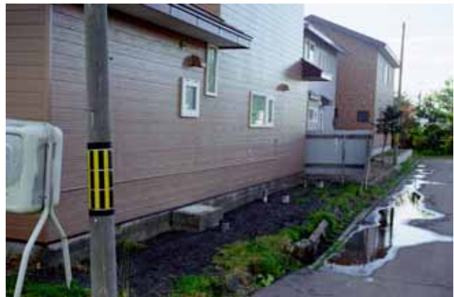
写真 - 16 周辺住宅の被害状況
