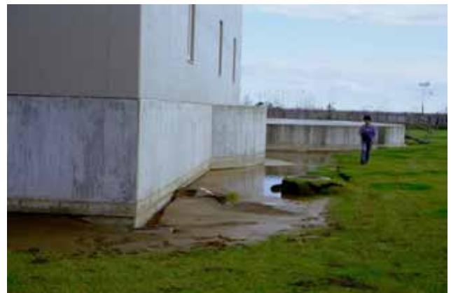
写真 - 10 施設周りの地盤が液状化により沈下し，一面噴砂が見られる
