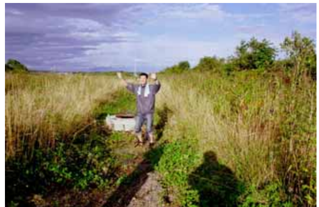
写真 - 12 マンホールの浮き上がり 周辺は湿地帯である
