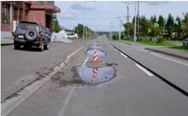
写真 - 17 下水道管路埋設部における路面の沈下
