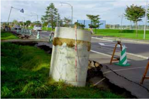
写真 - 13 マンホールの浮き上がり 約 1.6m
