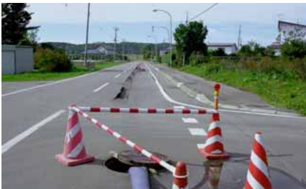
写真 - 19 下水道管路埋設部における路面の沈下
