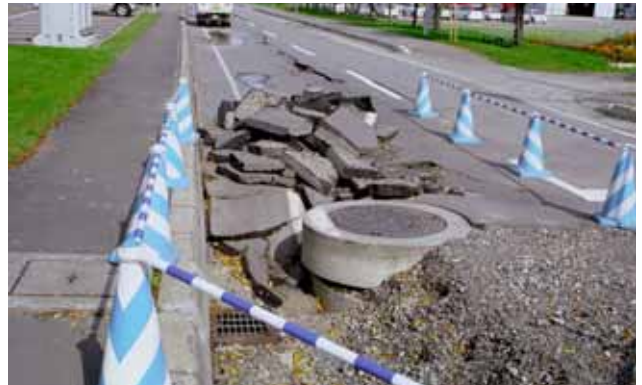
写真 - 18 マンホール側塊のズレ
