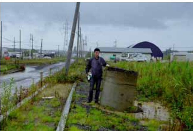
写真 - 7 未舗装部のマンホールの浮き上がり
