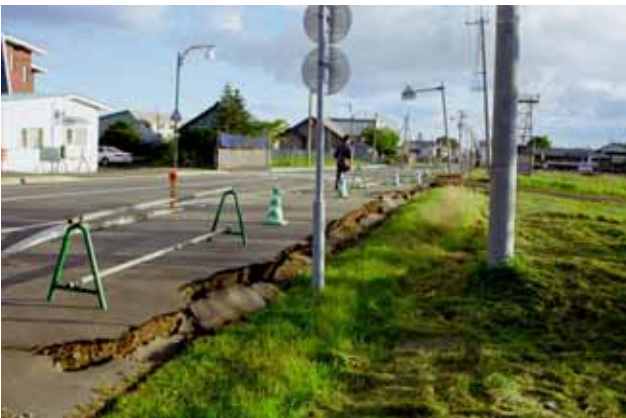
写真 - 15 管路埋設部の沈下，陥没
