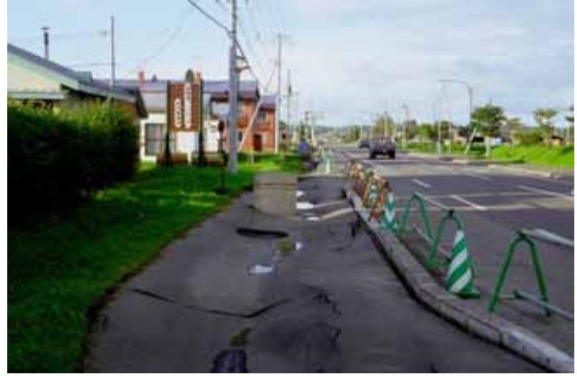
写真 - 14 管路埋設部の沈下，陥没
