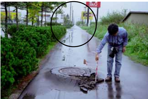
写真 - 3 木場地区でのマンホールの浮き上がり 看板付近にマンホールの浮き上がりは 見られない(印参照)。
