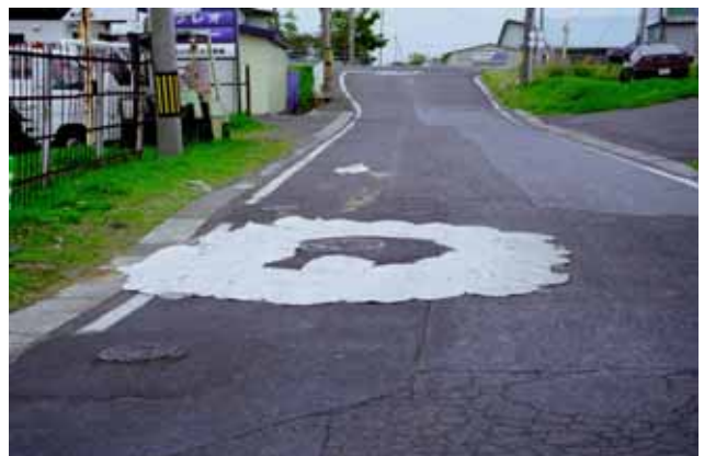
写真 - 22 陥没部に土嚢が敷かれていた
