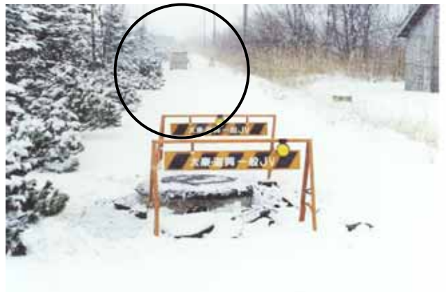
写真 - 4 同じ地点での1993年釧路沖地震に おけるマンホールの浮き上がり (写真提供：愛媛大学工学部 森助教授)
