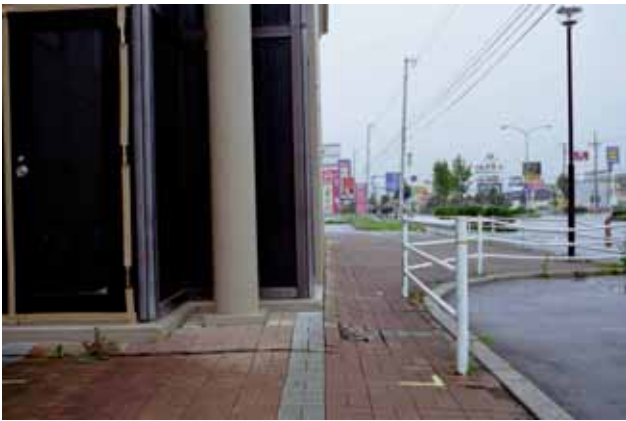
写真 - 1 ポスフル(旧ニチイ)の建物周辺の被害状況
