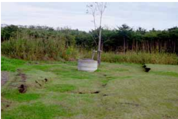
写真 - 11 マンホールの浮き上がりと周辺地盤の陥没
