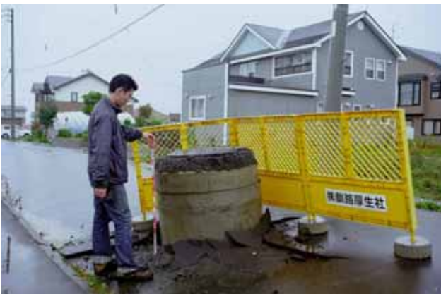
写真 - 5 マンホールの浮き上がり
