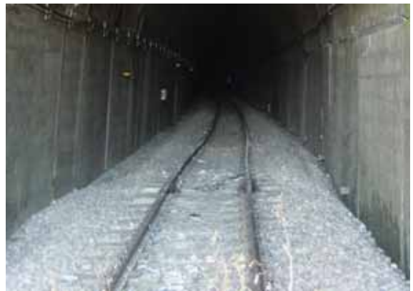
写真-2 JR 榎トンネル南坑口内部の様子．線路に軌道狂いが見られ，バラストの波打ちがある．
