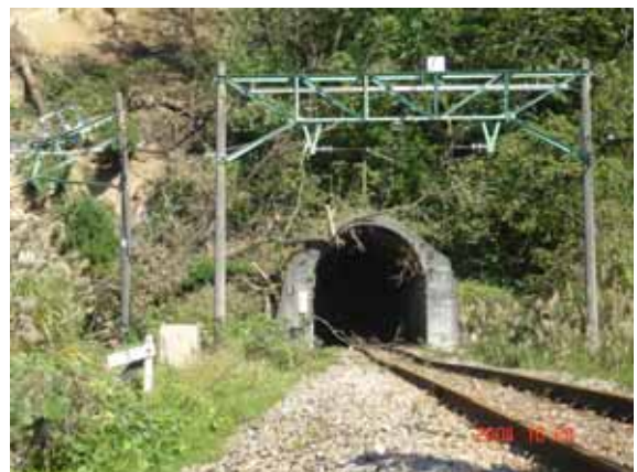
写真-1 JR榎トンネル南坑口の様子。斜面崩壊の直接の影響はない。線路にうねりが見られる。
