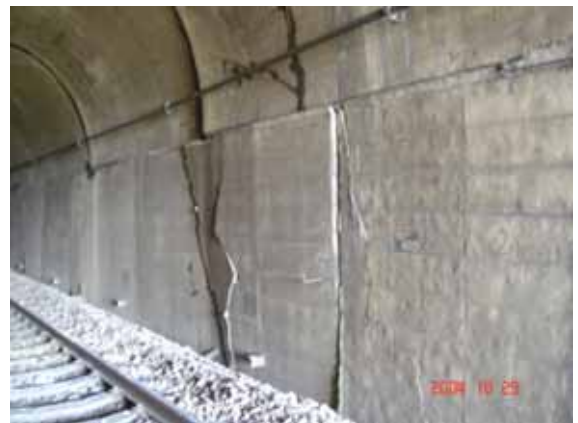
写真-3 JR 榎トンネル南坑口東側壁の被害．側壁の亀裂とせり出しが明瞭に認められる．
