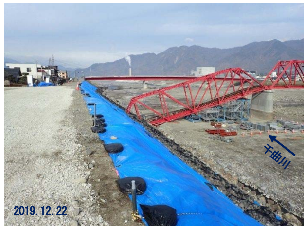
写真-1 千曲川橋梁の落橋状況
