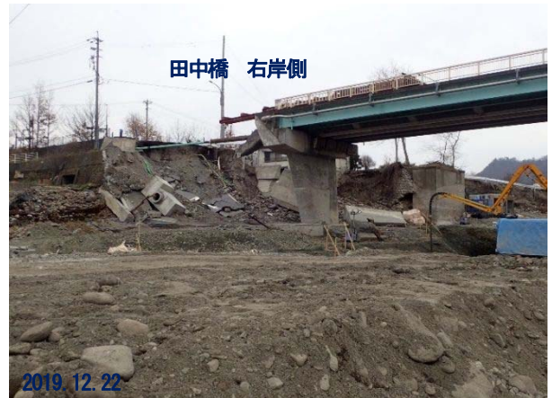
写真-3 田中橋の被災状況
