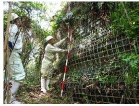
写真-2 緑化テールアルメ工の壁面の変状
