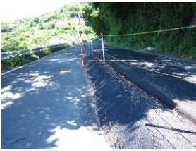
写真-1 地すべり災害による道路の段差
